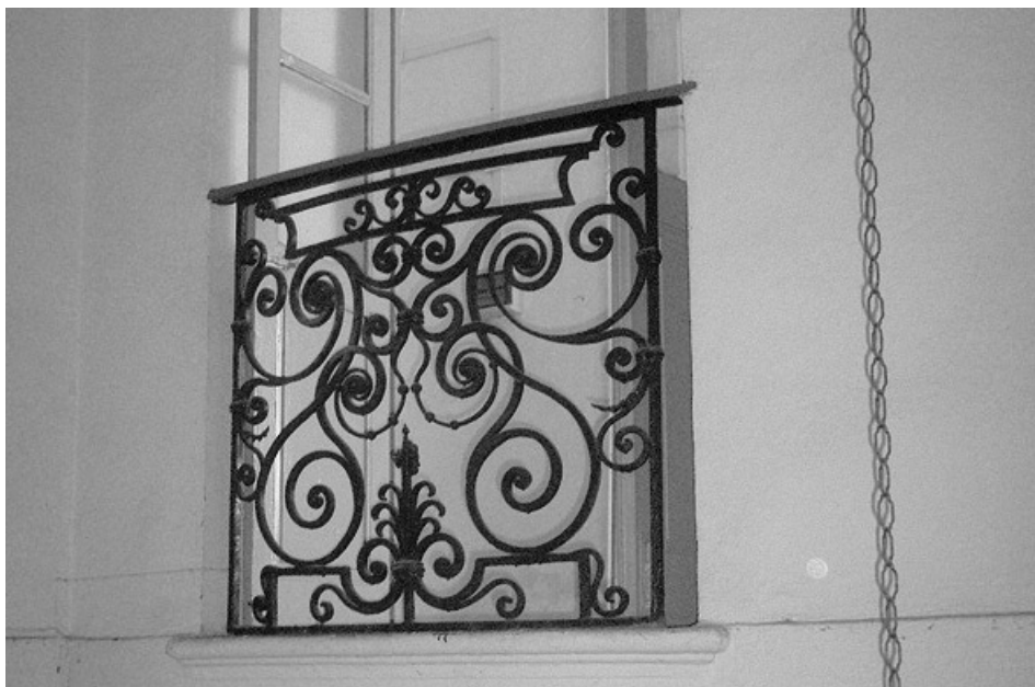
Tav. 3 - Pontremoli, palazzo del marchese Luigi Malaspina di Mulazzo: dettaglio del parapetto della finestra della scala d'accesso al piano nobile.
