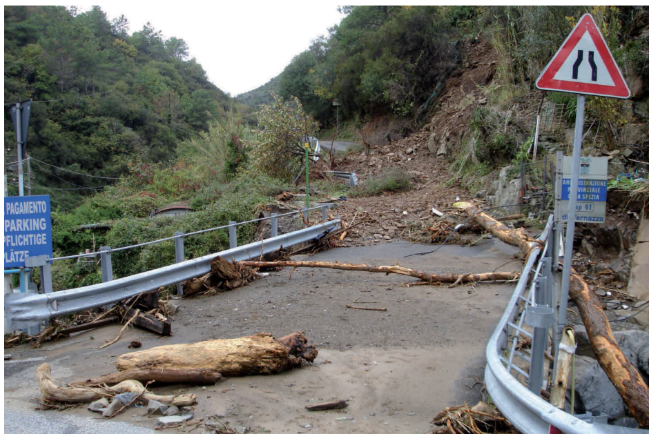
Figura 4: il ponte che attraversava il Canale di Vernazza all'inizio della S.P. 61 "Drignana-Vernazza"; i tronchi d'albero segnalano l'altezza raggiunta dall'onda di piena, in sinistra della foto il segnale che indica l'area di parcheggio oggi completamente asportata dalle acque.
