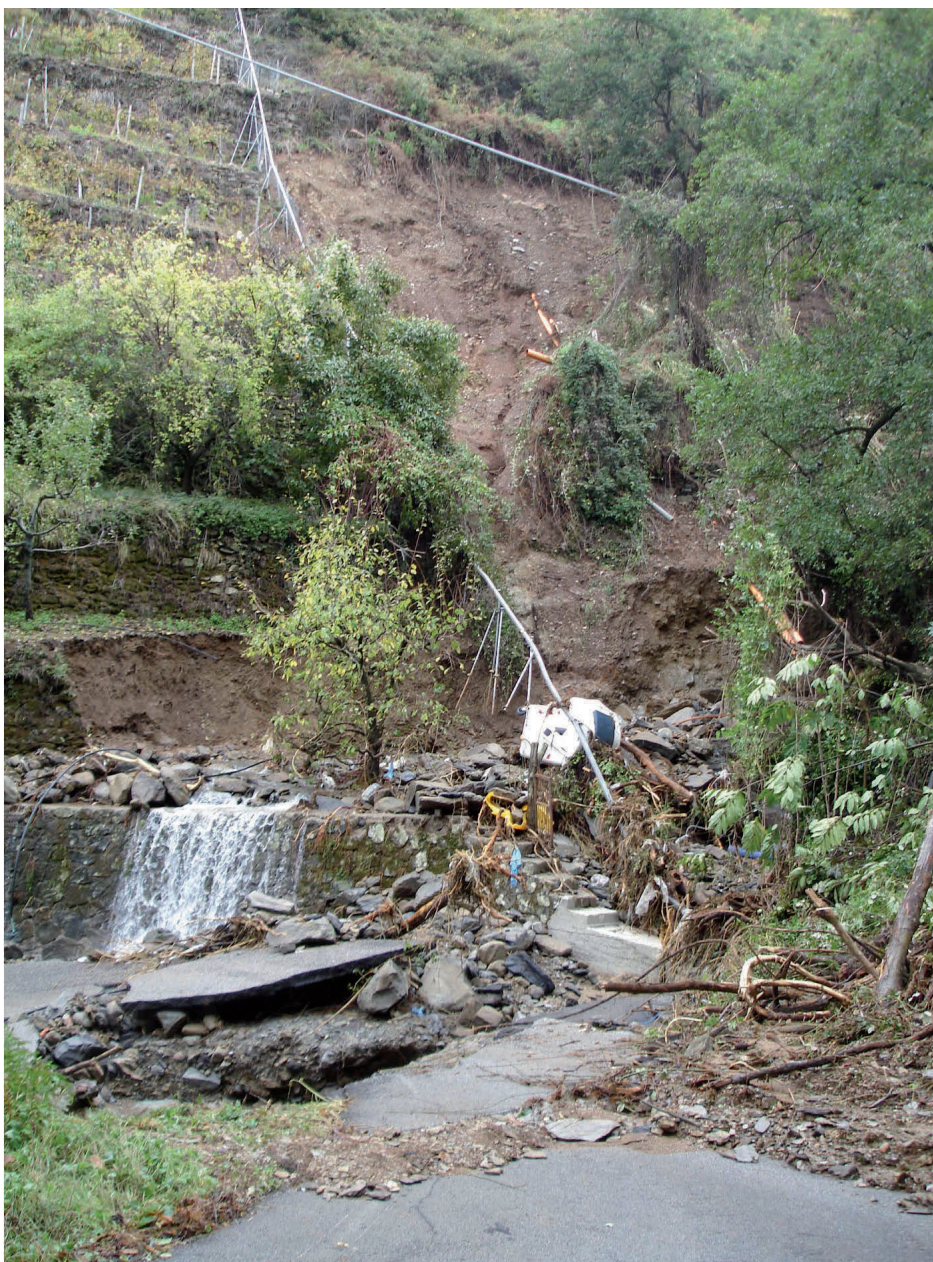
Figura 3: una delle numerose interruzioni della S.P. 30 per Corniglia qui causata dall'erosione delle acque di un solco vallico minore.
