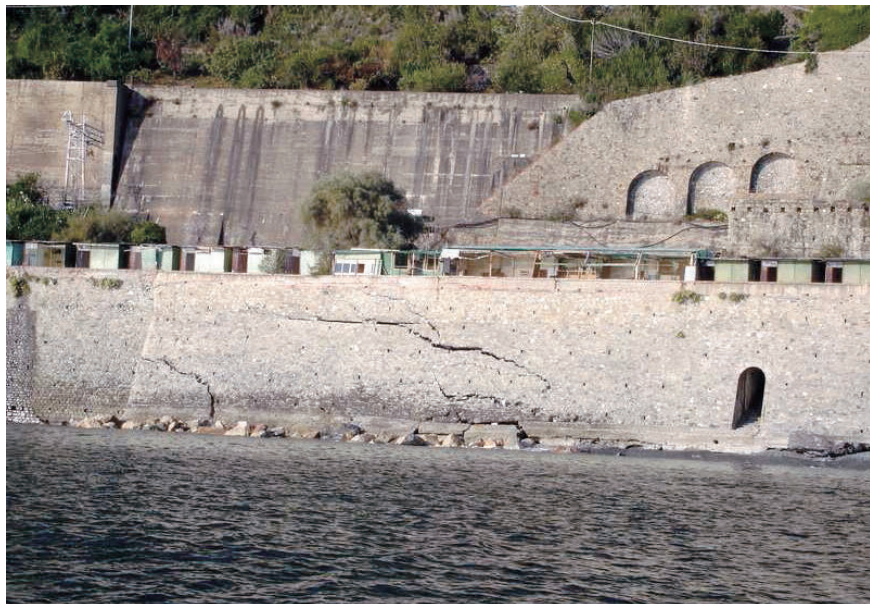
Foto n. 23 – Il recente cedimento del muraglione della ferrovia a Corniglia
