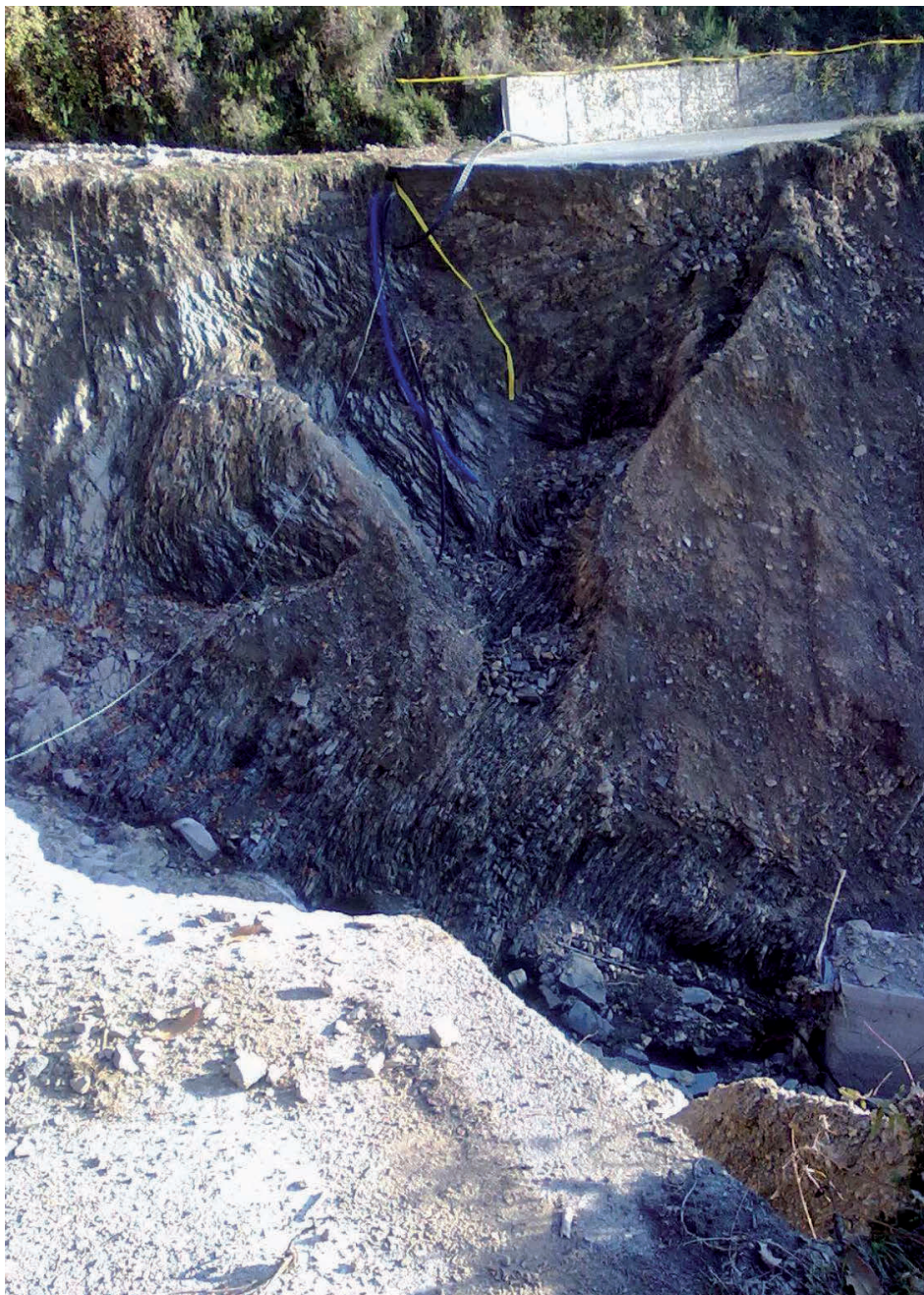
Figura 8: l'erosione delle acque incanalate lungo la S.P. 51 "dei Santuari" ha asportato un rilevato di attraversamento di un solco torrentizio, portando in affioramento la roccia del substrato.
