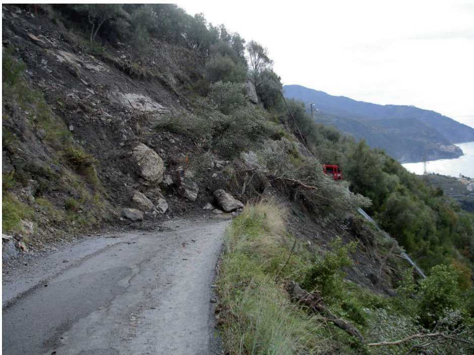
Figura 2: uno scoscendimento della scarpata a monte della Strada Provinciale n. 30 nel tratto che da San Bernardino scende a Corniglia: il dissesto coinvolge un ammasso detritico formato da blocchi calcarei in matrice argillitica.
